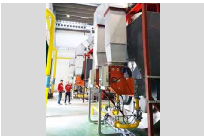
CALEFACCIÓN URBANA Modelos de quemadores: Nº6 IB 1200 G ME LX - modulación electrónica - Cabezal de combustión de bajo NOx - Control de O 2
