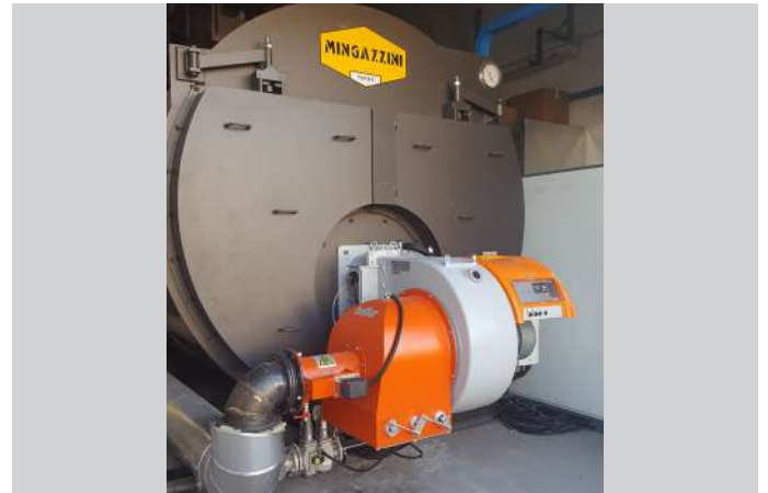
造纸厂 - 特殊项目 燃烧器型号: TBG 1100 ME V O2 FGR - O 2 控制器、变频器和燃气再循环系统 NO x <80mg/kWh
