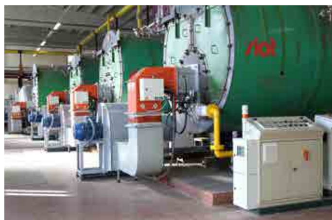
RISCILDAMENTO STRUTTURA OSPEDALIERA Modelli bruciatori: N° 2 IB 650 G ME CO V, N° 2 IB 1200 G ME CO V - modulazione elettronica - inverter e controllo CO NO x <100mg/kWh
